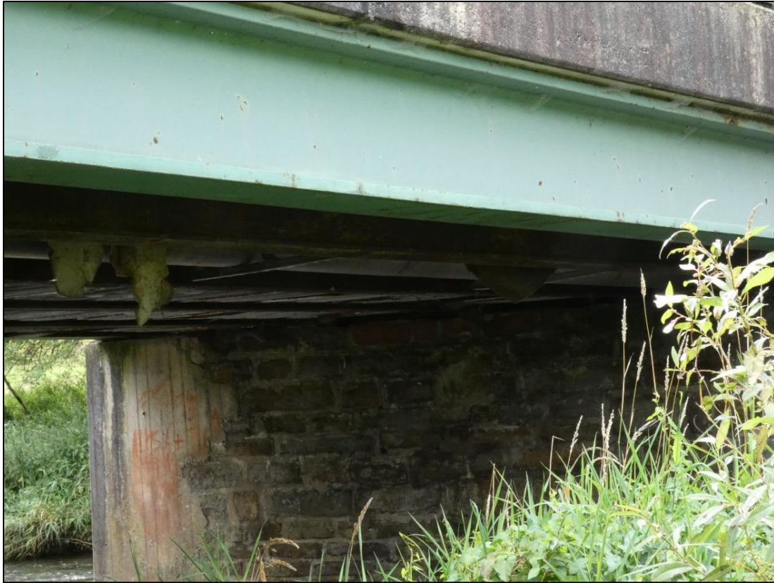
Abb. 8: Unterhalb der Brück ist z.T. abplatzendes und herunterhängendes Material erkennbar.
